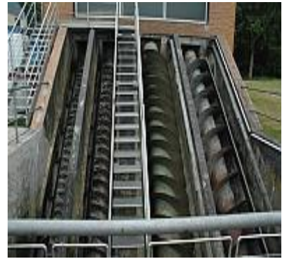
Vorpumpwerk: Hier kommt das Abwasser aus Eschweilers Stadtteilen in die Kläranlage.
